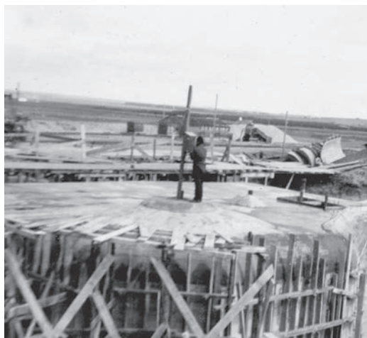
Bunker til M19-morter under bygning. Bunkeren er færdigstøbt, men hele forskallingen er endnu ikke fjernet. Efterfølgende blev der fyldt jord omkring bunkeren, så dets tag kom til at ligge helt plant med jordoverfladen. (Museumscenter Hanstholm).
