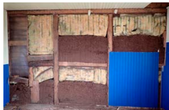
»Udsigten«s østvæg efter at de fleste af vægbrædderne var fjernet. Bortset fra det nordligste fag, som var forstyrret af indbygning af et vindue, var væggen velbevaret med den oprindelige isolering af tørvestrøelse. Bunkermuseum Hanstholm.
